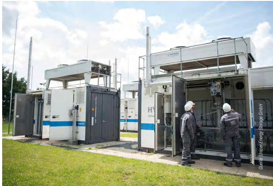
Blick in einen Container mit jeweils vier Elektrolyse-Stacks
