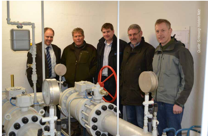
(v. l. n. r.) Projektleiter Jörg Rudat, Neukirchens Bürgermeister Peter Ewaldsen, Netzcenterleiter Sönke Nissen, Klanxbülls Bürgermeister Friedhelm Bahnsen und Kommunalbetreuer Dirk Lucht beim Pressetermin am 14. März 2014
