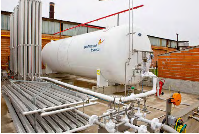
LNG-Anlage beim Endverbraucher, links atmosphärische Verdampfer
