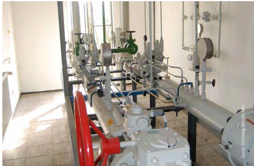
Hier wird das Erdgas von der Transportleitung in das Verteilernetz eingespeist.
