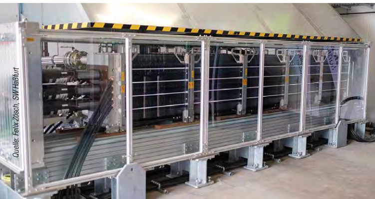
Herzstück der Power-to-Gas-Anlage ist der PEM-Elektrolyseur.
