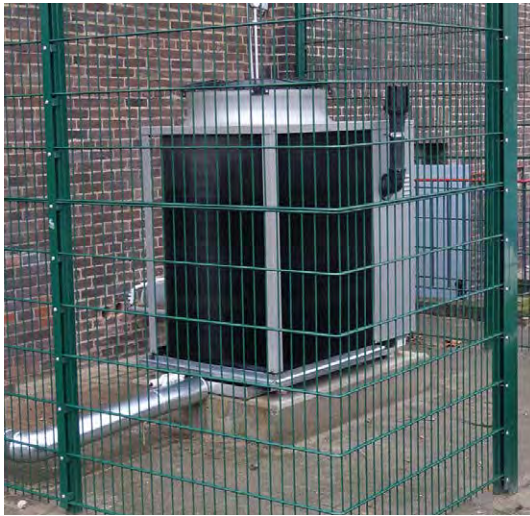
Gas-Wärmepumpe in Einhausung
