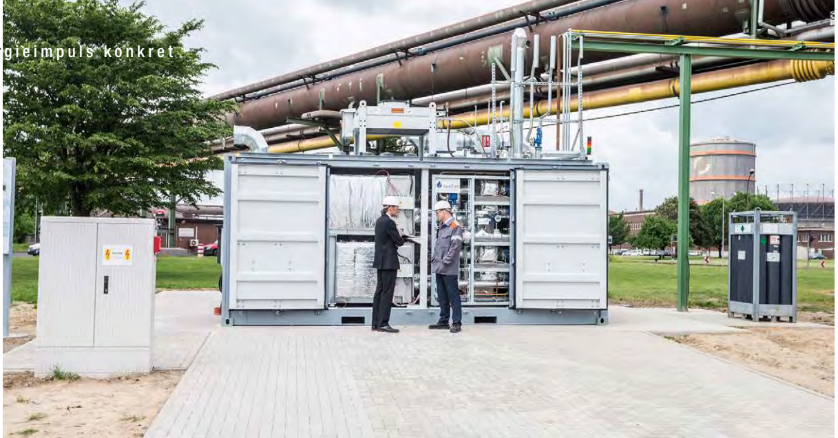
Seit Juli 2017 ist bei der Salzgitter Flachstahl GmbH das Dampf-Elektrolyse-Model (SOEC) in Betrieb.
